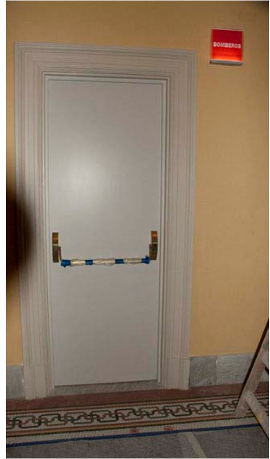
Foto tomada durante la 2ª Inspección ocular
